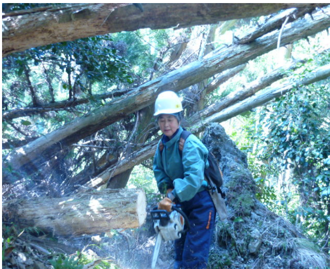
施行中 風倒木（壊滅状態）
